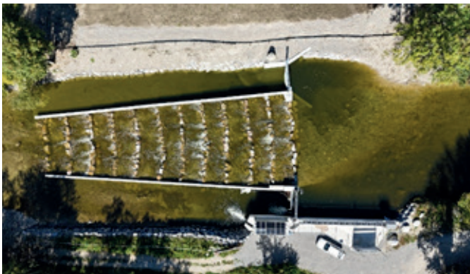
Wehranlage mit ökologischer Durchgängigkeit der WKA Schomburg, Bild: D-Energy GmbH & Co. KG
