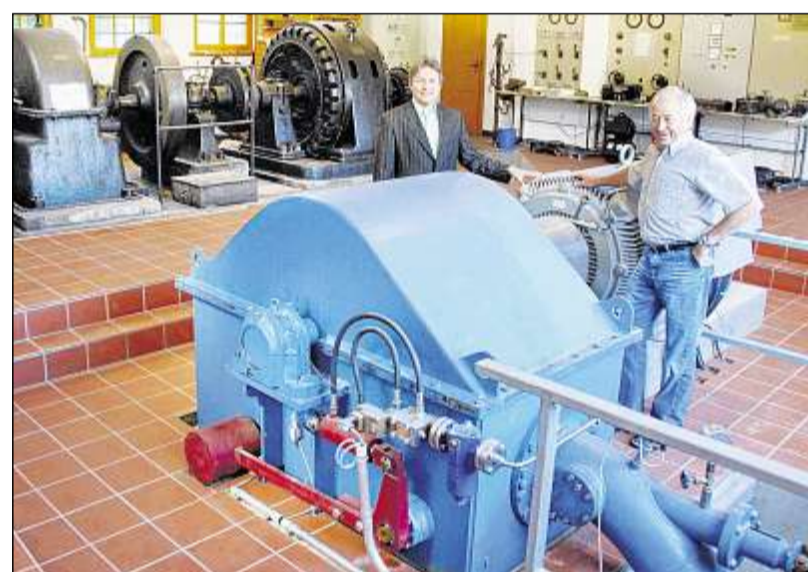
STOLZ präsentiert Bürgermeister Oliver Rastetter (links) das renovierte Wasserkraftwerk in historischer Umgebung. Foto: Margull
